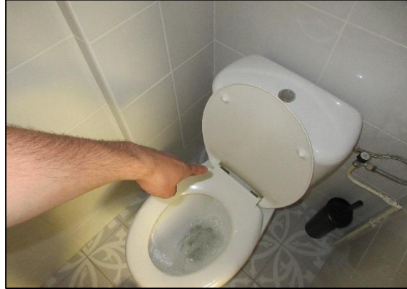
2. Speling op toilet.
