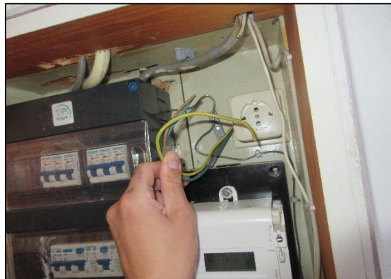
4. Stopcontact niet aangesloten: nazien/afmonteren, PM.
