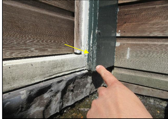
8. Loszittende betimmering: nazien/vastzetten, icm. waterkerend dichten van (openstaande) houtwerken.
